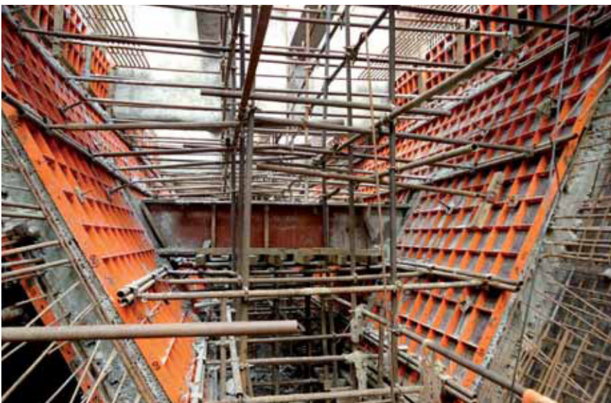
Bunker für ein Heizkraftwerk, Babandh, Orissa, Indien
