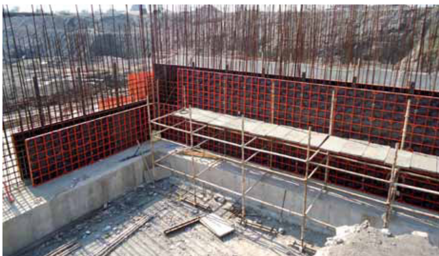
Stahlwerk, Rourkela, Orissa, Indien
